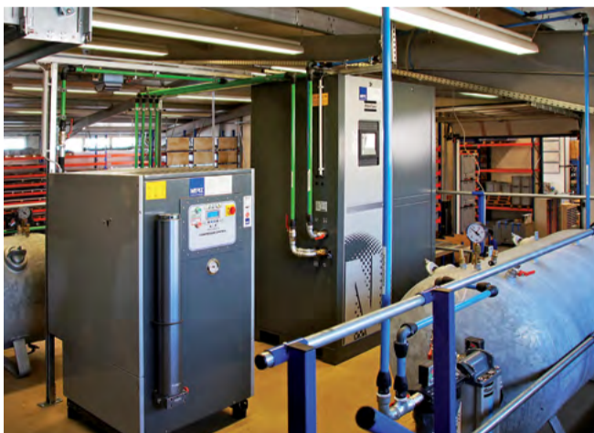
Der im N 2 -Generator (hinten im Bild) erzeugte Stickstoff wird mit dem Booster auf bis zu 300 bar nachverdichtet und anschließend in einem Flaschenbündel zwischengespeichert.
