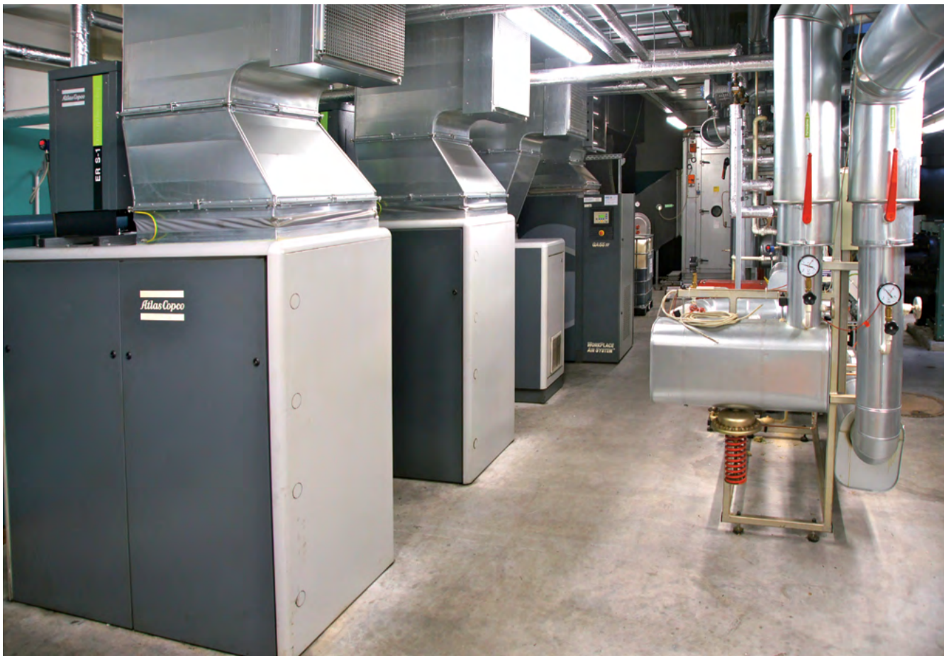
Die GA-Kompressoren wurden mit externen ER-Wärmerückgewinnungseinheiten nachgerüstet. Die Maßnahme hatte sich schon nach sechs Monaten amortisiert.
