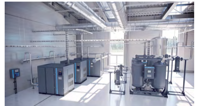
Beispielinstallation mit den neuen, drehzahleregelten Kompressoren der Baureihe ZR 160 VSD + vorne im Bild sowie übergeordneter Steuerung an der Wand.
